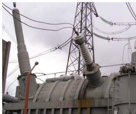
Рисунок 1.5 – Вводи 154 кВ та 750 кВ автотрансформатора
